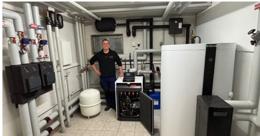
Sole-Wasser-Wärmepumpe, die die Erdwärme nutzt, mit Pufferspeicher, Frischwasserstation und neuer Heizkreisverteilung - der Kunde ist mit der Leistung des Fachbetriebs Oswald sehr zufrieden.
